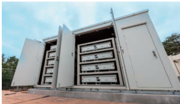
群馬県嬬恋村に蓄電所を設置し調整力の脱炭素化を推進
