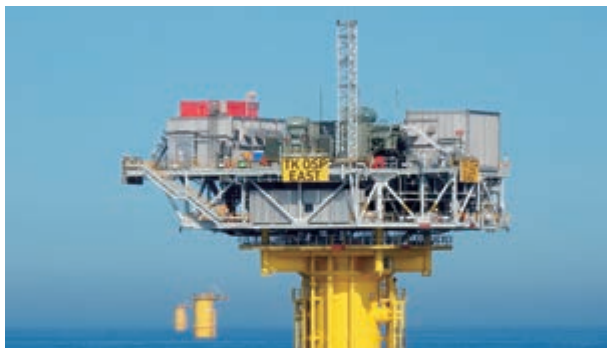
昨年12月に海底送電線設備の運用を開始したイギリスの洋上変電所
