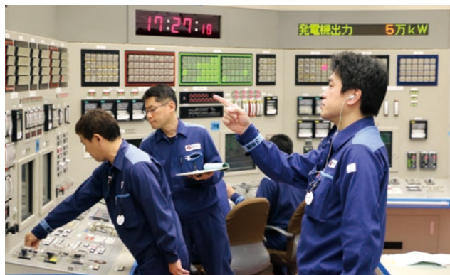
大飯発電所3号機並列操作の様子
