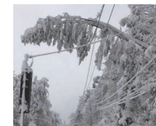
設備被害状況
