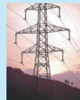
220kV送電線 (中国東幹線)
