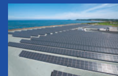
三国太陽光発電所
