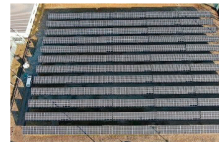
設置した太陽光発電所(1,024kW)
