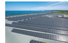
三国太陽光発電所
