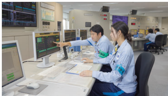
中央制御室運転状態確認
