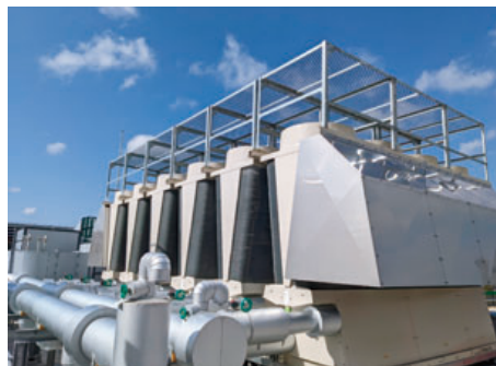
空調設備 (ヒートポンプチャラー)
