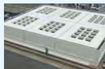
海水ポンプの浸水防止対策
