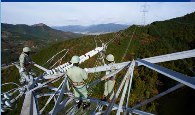
50万V四国中央西幹線での送電線点検
