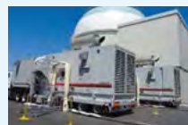
空冷式非常用発電装置
