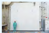
大型水密扉（扉の厚さ35cm）
