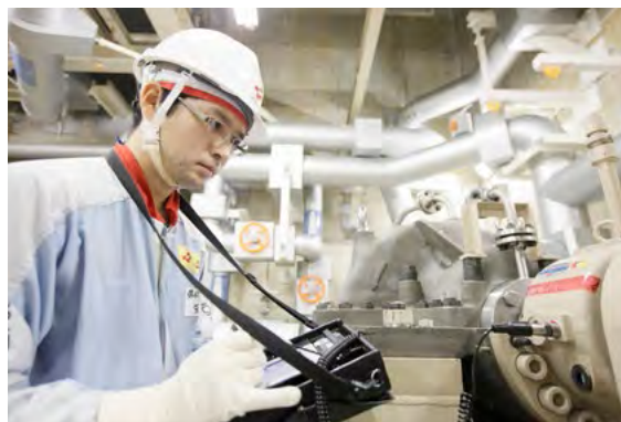
運転員による定期点検
