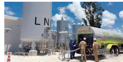
アワセ天然ガス供給センター
