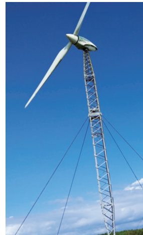
▲可倒式風力発電設備
