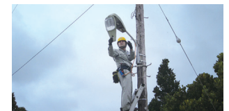
▲地域奉仕活動（電気設備無料点検）
