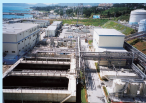
総合排水処理装置
