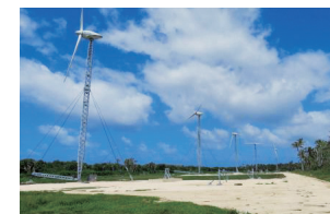
トンガ王国へ納入した可倒式風力発電設備
