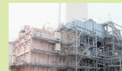
排煙脱硫装置
