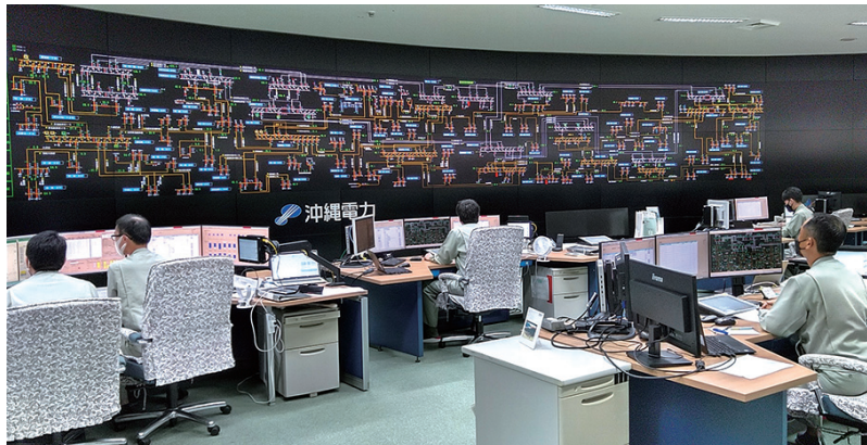
▲電力系統の運用監視
