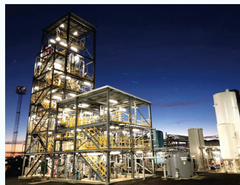
豪州褐炭ガス化・水素製造設備 提供: HySTRA, J-POWER/ J-POWER Latrobe Valley
