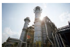
④ カエンコイ2ガス火力発電所運転開始
