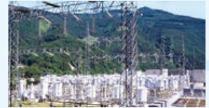
再エネ拡大に貢献する電力ネットワーク設備
