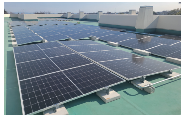
横浜市立元街小学校に導入した太陽光発電設備とカーボンネガティブコンクリート
