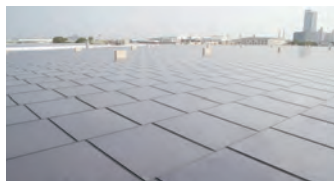
西島太陽光発電所
