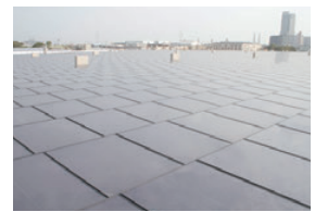
西島太陽光発電所
