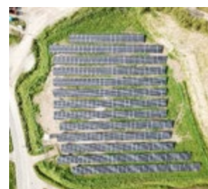
MIRARTH ホールディングス株式会社グループが開発した太陽光発電所 (熊本県)
