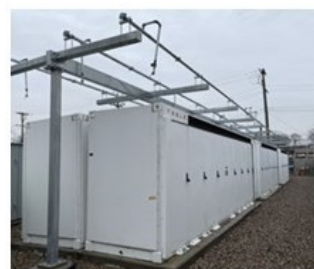
系統用蓄電池の外観
