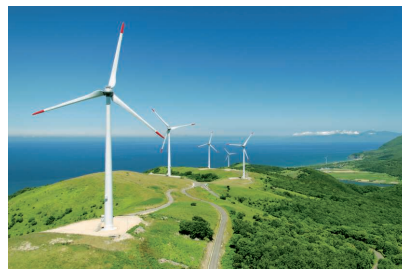
尻別風力発電所（北海道）
