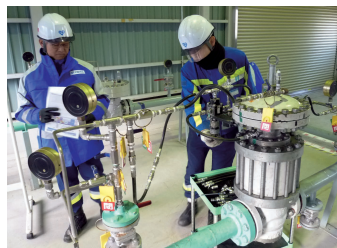
供給設備の操作訓練
