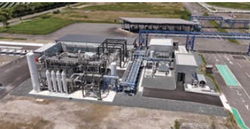
知多緑浜工場水素製造プラント
