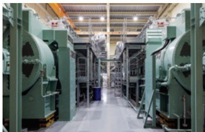
ガスエンジン発電機
