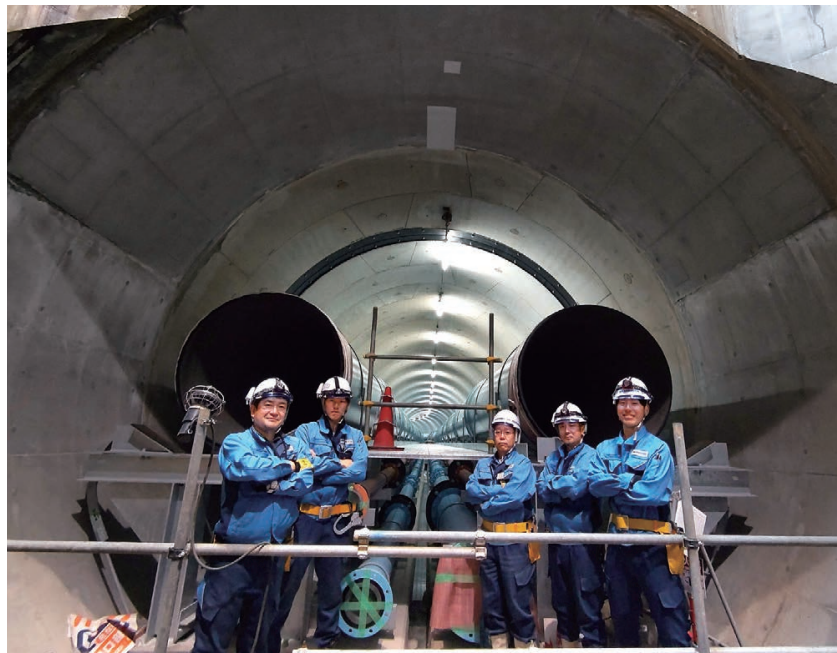
▲工事中の配管路にて。中央に2本あるのが送水管で、直径は1.5メートル。 人が立つとその大きさが実感できる。
