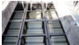
ろ過部を組み込んだ最終沈殿池
