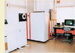
当時の電算室機械室
