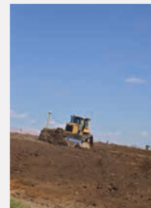
3 DMCや3 DMGを使った情報化施工 Digital Construction Using 3DMC and 3DMG
