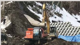
北海道勇払郡厚真町の林地荒廃防止施設災害復旧工事
