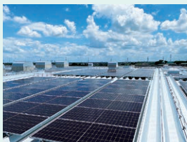
▲屋根上の太陽光パネル
