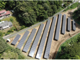
セコム専用の太陽光発電所
