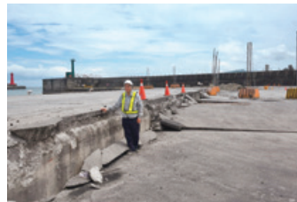
花蓮港の液状化被災状況
