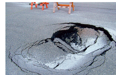
▲管路施設の老朽化等に起因して発生した道路陥没
