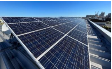
大阪南営業所 太陽光発電設備(2013年)
