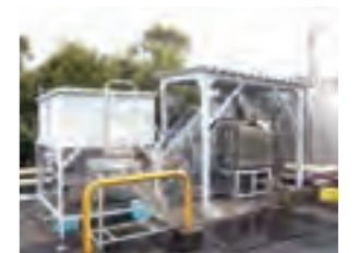
生ゴミ排出量の削減に大きく貢献している生ゴミ処理機(東京工場)
