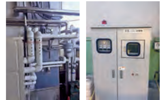
灯油使用量の削減に大きく貢献している「エコキュート」(東京工場)
