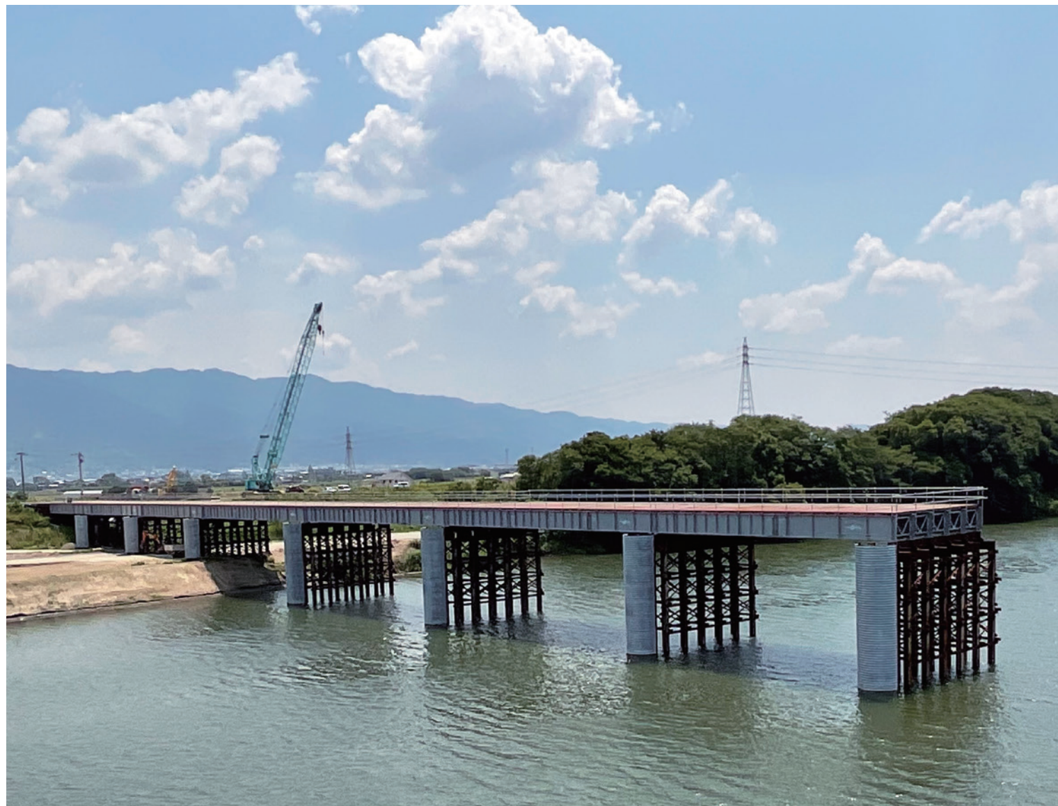
福岡県久留米市 県道甘木田主丸線 両筑橋仮栈橋設置工事
